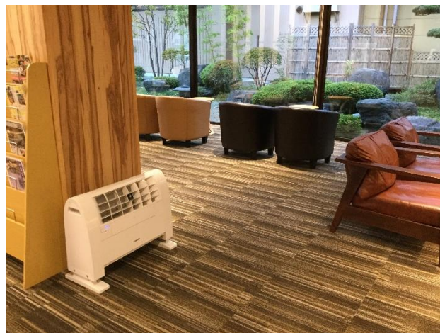
大型空気清浄機の設置
